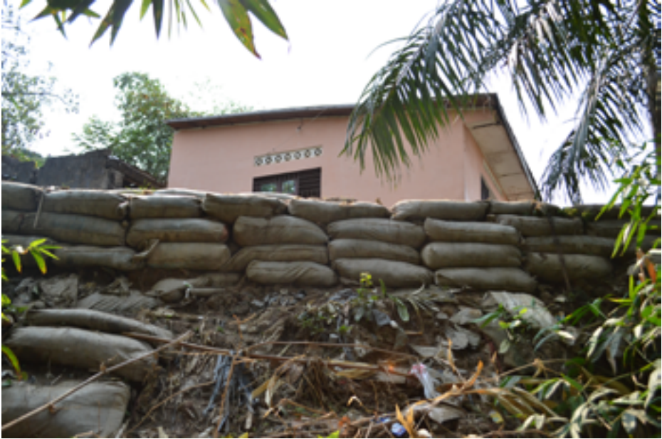
Figure 6 : Des sacs de sable pour empêcher l'érosion
