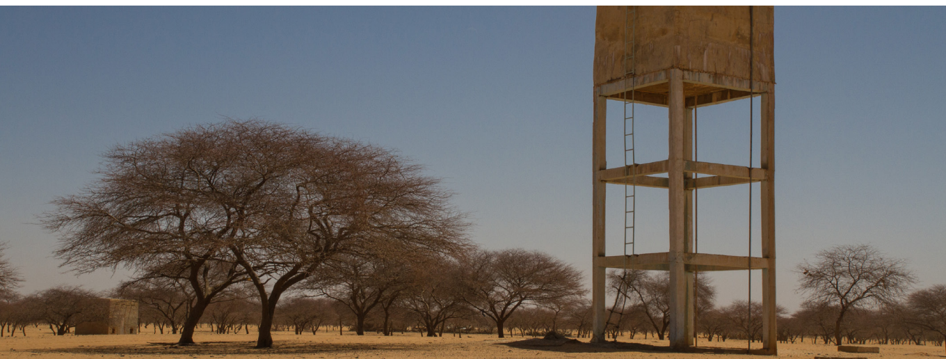
Construction d'un forage pour apporter de l'eau aux populations dans la région d'Hodh El Chargui, en Mauritanie. © OIM 2018 / Sibylle DESJARDINS
