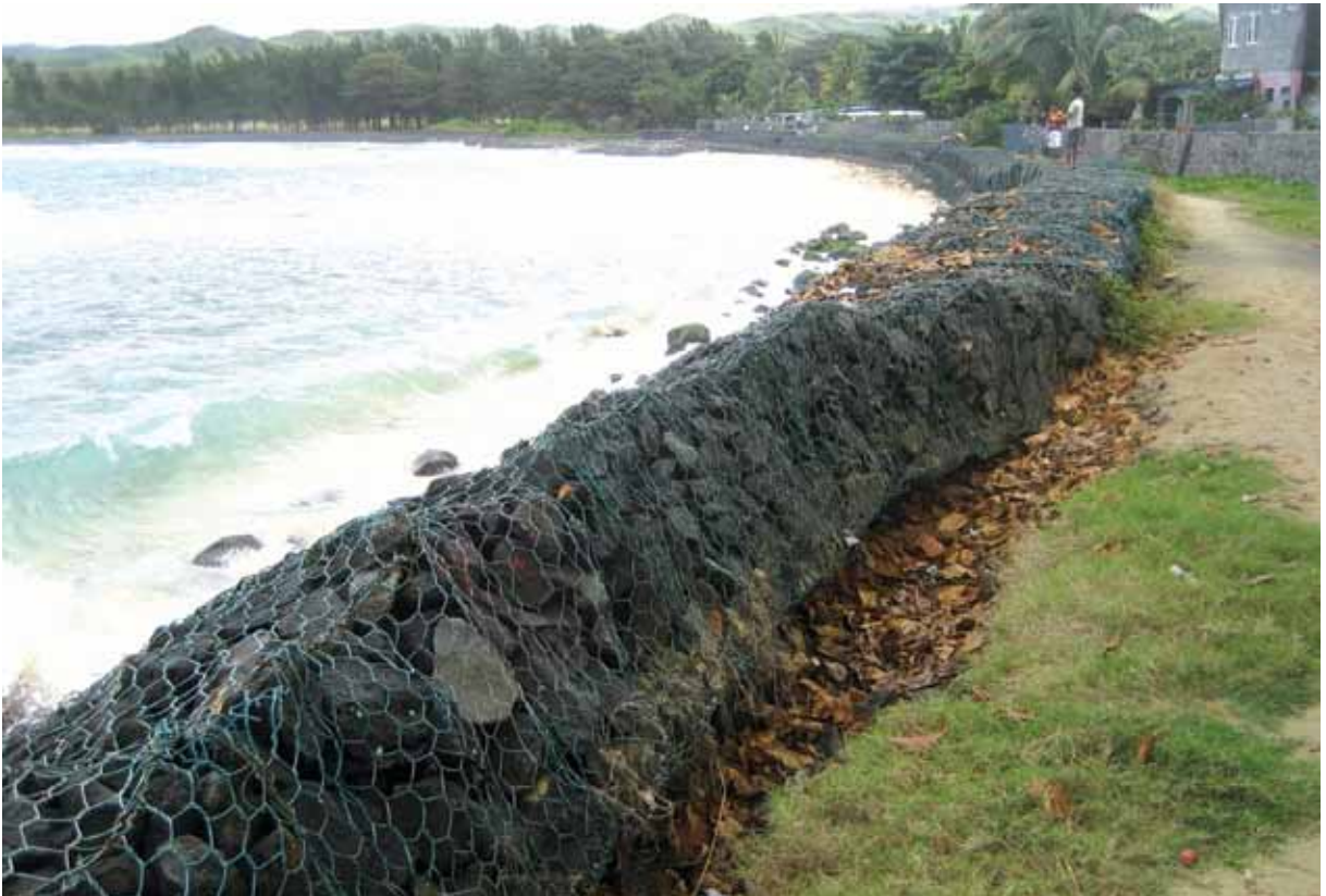
Gabions on the beach of Rivière des Galets. © IOM, July 2010 (Photo: François Gemenne).
